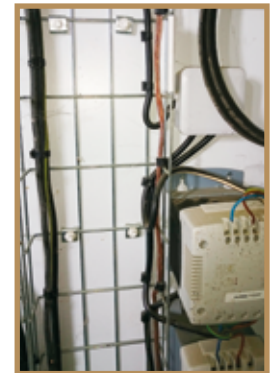
Chemin de câbles mis à la terre
